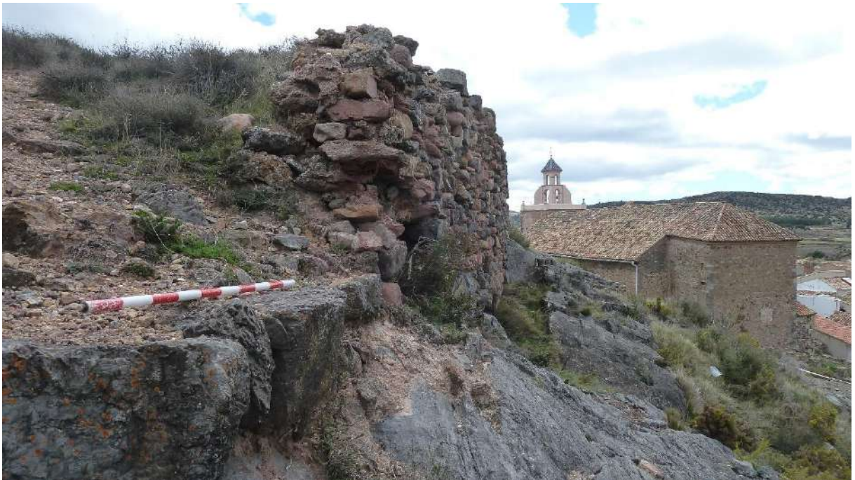
20. Vista detalle de los restos de muro
